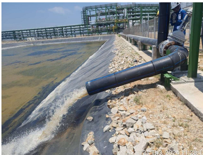
Hình 3. Bể chứa tạm nước thử thủy lực
